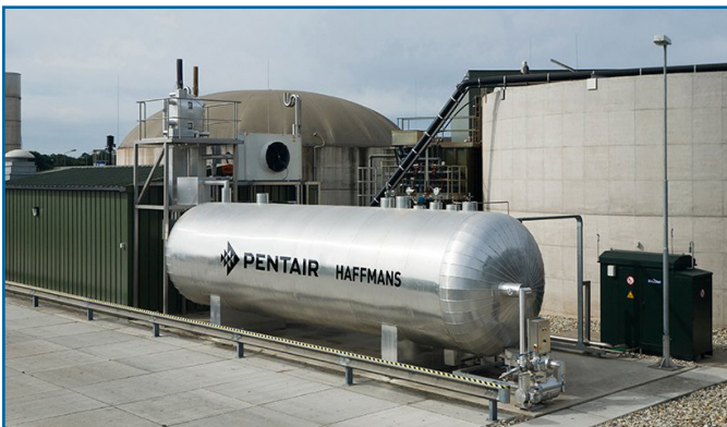
CO 2 -Speicherung in der Biogasaufbereitungsanlage von Ecofuels in Well, Niederlande
